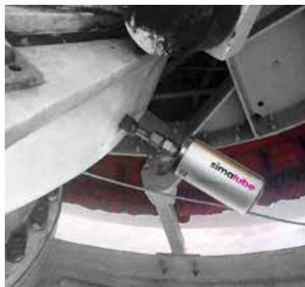
In deze windturbine werd het simalube smeerpatroon ingesteld op een doseertijd van zes maanden.
