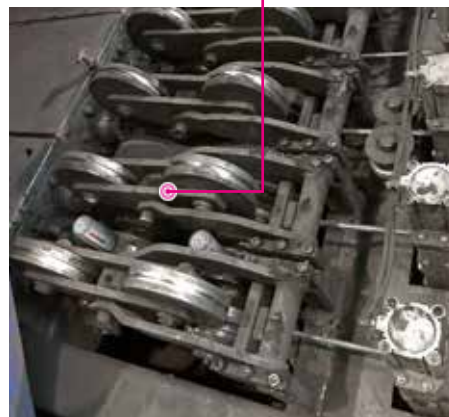
simalube 125 ml smerpatronen geïnstalleerd op de aanvoer van een uitlijn- en snijmachine en staan ingesteld op 6 maanden.
