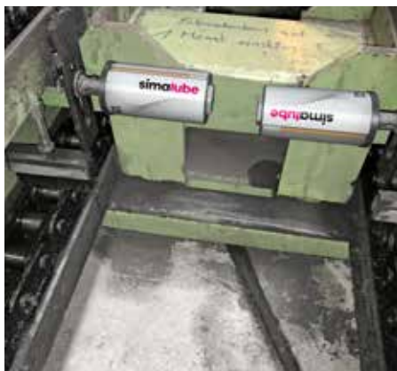
simalube patronen (125 ml) en borstels geïnstalleerd op kettingtransportband. De kettingen worden continu gesmeerd en gereinigd.
